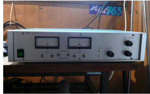
写真 4-5 電磁流速計アンプ
