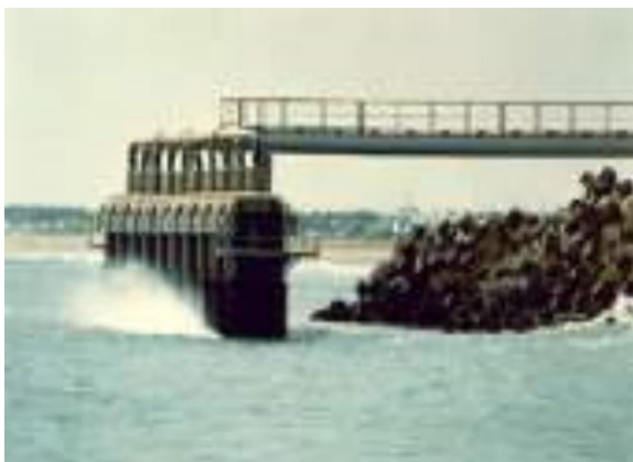
写真 2-5 定圧化タンク方式波力発電システム
