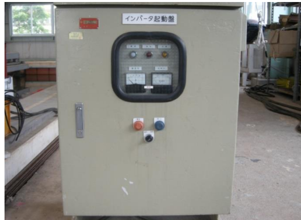
写真 5-21 インバータ起動盤(11kW,200V)
