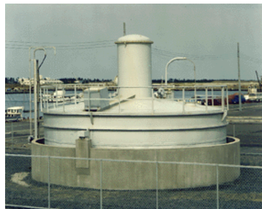
写真 2-6 定圧化タンク
