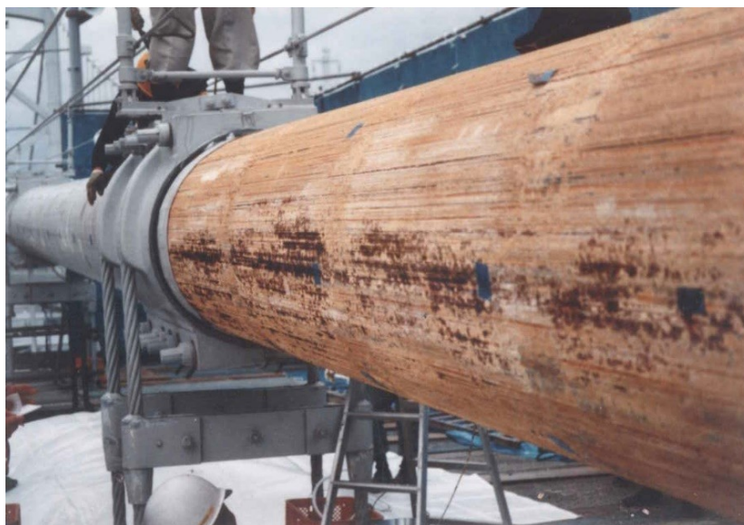
写真-1.2.9 因島大橋（広島県）のケーブル腐食 （写真提供：中村俊一氏）
