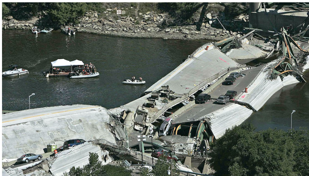
写真-1.2.1 崩壊後の米国の鋼トラス橋 (I-35W Mississippi River Bridge)
