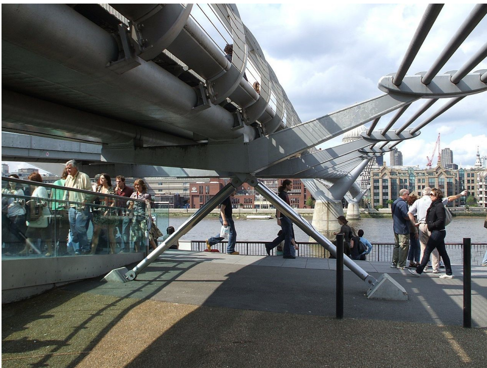
写真-1.1.13 水平振動が生じた後に取り付けられたダンパー (制振装置)
