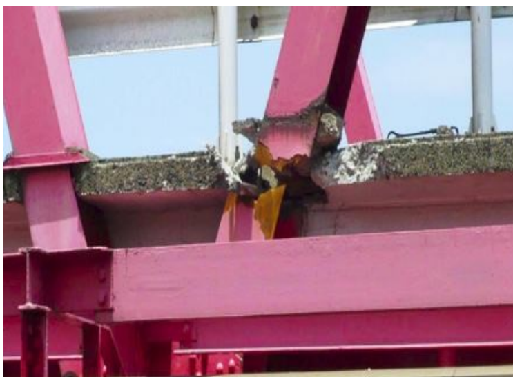
写真-1.1.8 本曾川橋（三重県）トラス斜材の腐食および破断部
