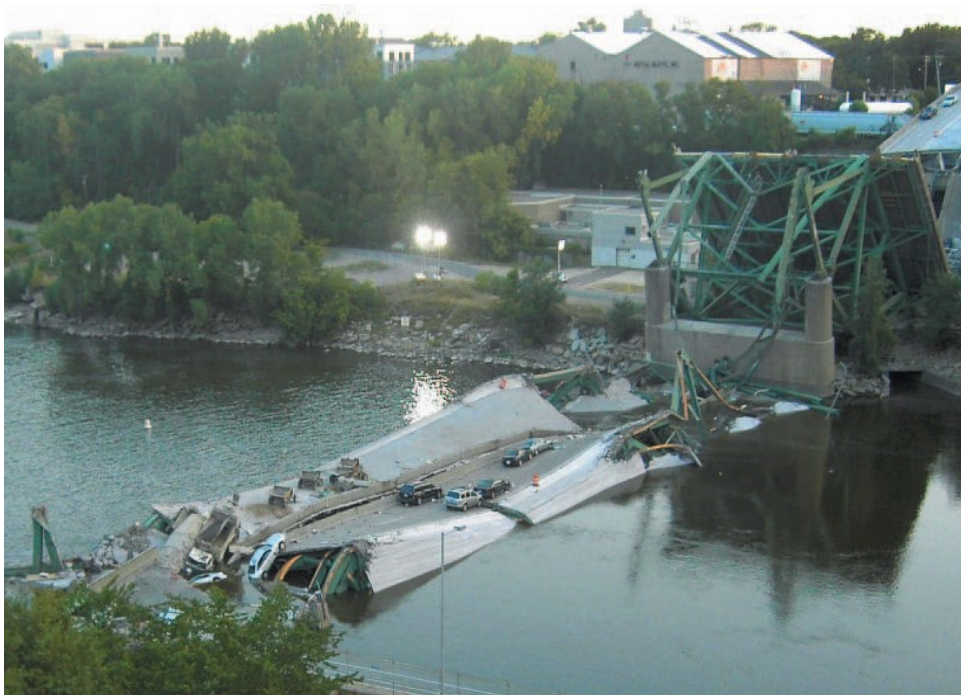
写真-1.1.6 崩壊後の米国の鋼トラス橋（I-35W Mississippi River Bridge）
