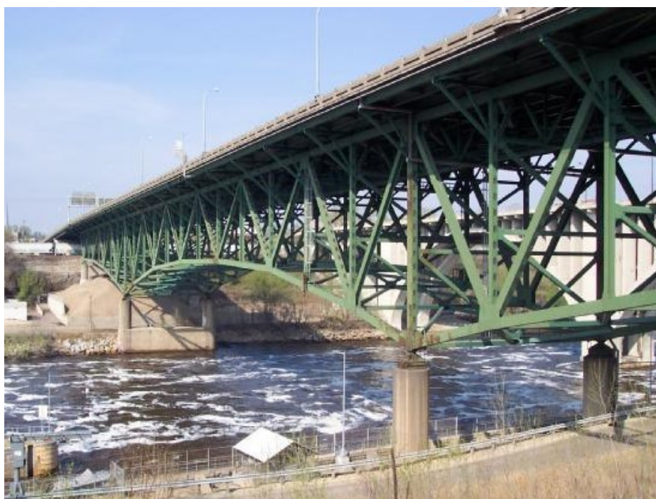
写真-1.1.2 I-35W Mississippi River Bridge (1967 年完成, アメリカ) (出典 : Wikipedia : http://ja.wikipedia.org )
