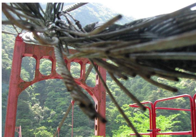
写真-1.2.10 原田橋（静岡県）ケーブル定着部の腐食ケーブル （写真提供：中村俊一氏）
