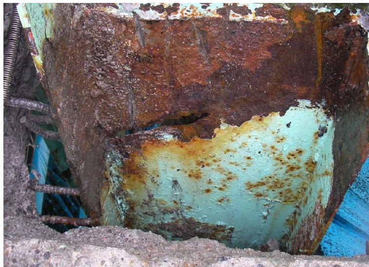
写真-1.1.7 本庄大橋（秋田県）トラス斜材の腐食部
