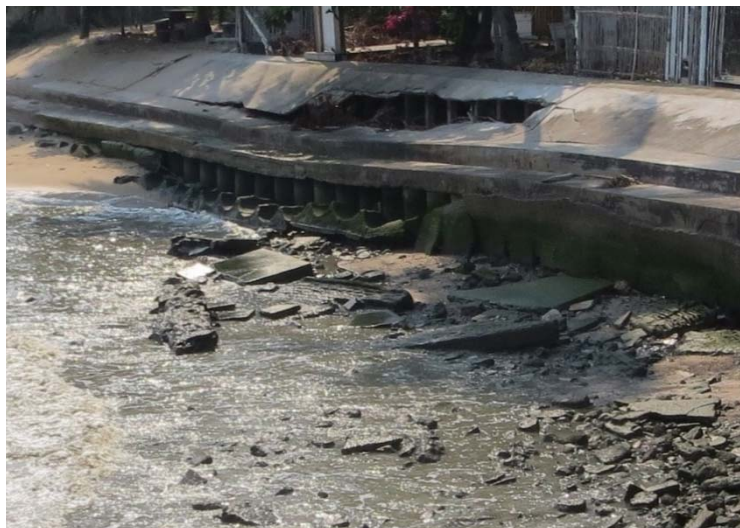
図 3.11 クロンワンビーチの海岸護岸での被災状況 (2012)
