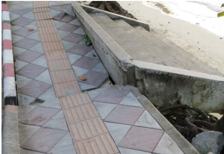
図 3.12 パトン湾南ビーチの道路護岸での被災状況（2013）
