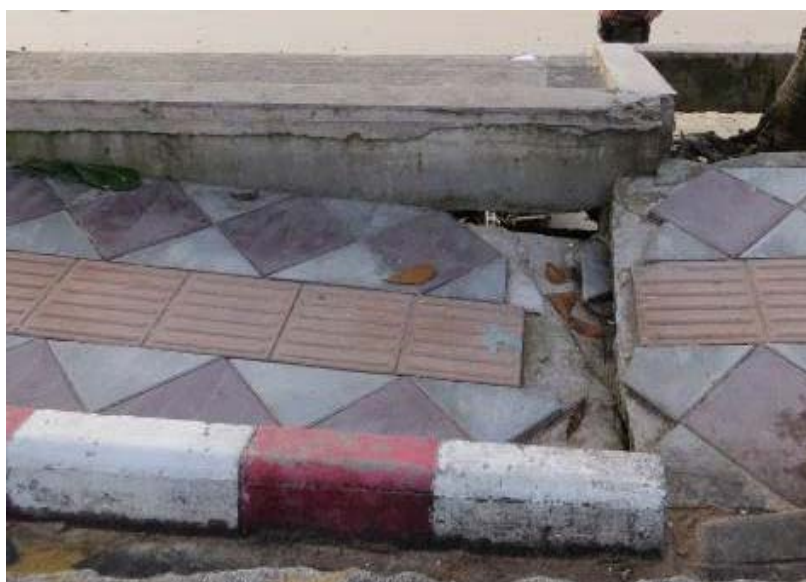
図 1.4 タイ国パトン湾南ビーチの道路護岸での被災事例（2013）
