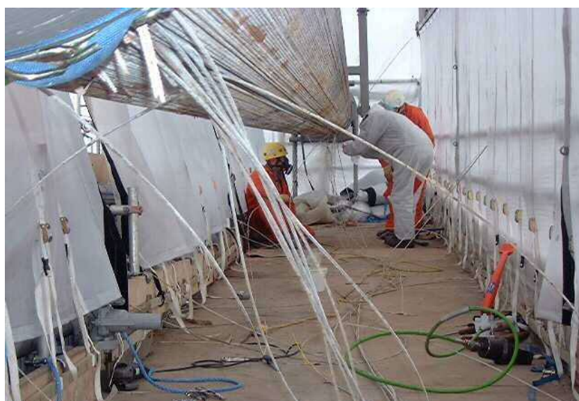
写真-3.1.2 橋梁用ケーブルの破断事例
