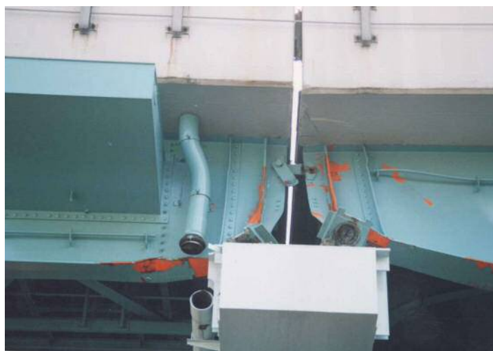
写真-1.2.12 鋼桁の局部座屈事例
