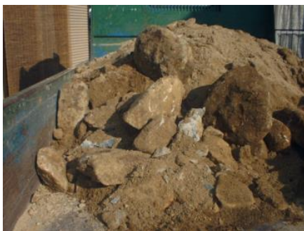
写真 2.1 不適切な盛土材料 (石等)
