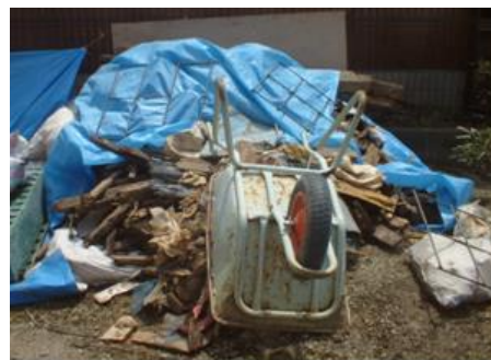
写真 2.2 不適切な盛土材料 (産廃等)
