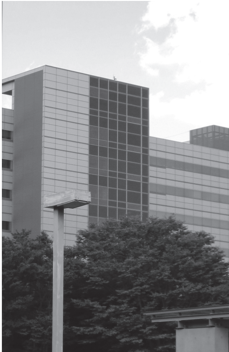
図 1 産業技術総合研究所研究棟（茨城県つくば市）に設置された太陽光発電設備
