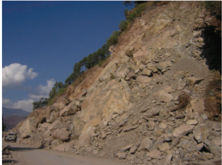
(d) Planar sliding failure
